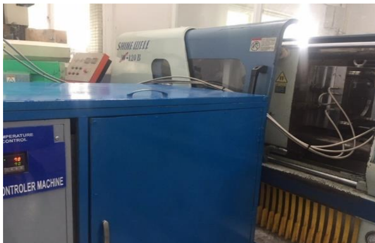
Hình 3.11: Kết nối hệ thống điều khiển nhiệt độ khuôn gia nhiệt bằng nước với bộ khuôn trên máy Shinewell - 120B
